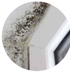
Moisissures sur les murs
